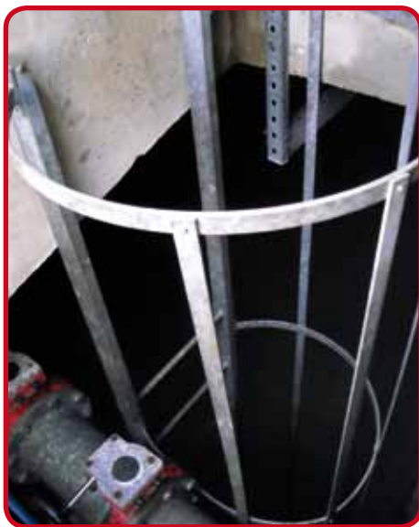
La crinoline bloque l'accès à l'échelle et nécessite un enjambement hasardeux. Les arceaux sont trop espacés, les plats filants sont fixés à l'extérieur des arceaux
