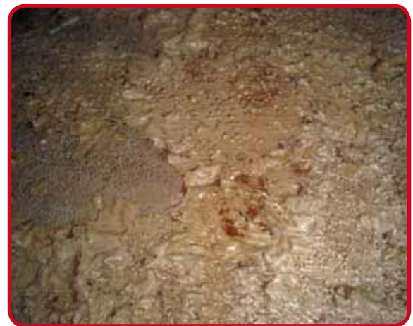
État final du cloquage : décollement par lambeaux
