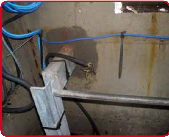
Câbles électriques sectionnés à portée de main
