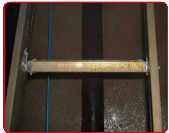
Matériau inadapté, corrosion et descelllement des barreaux sur échelle neuve
