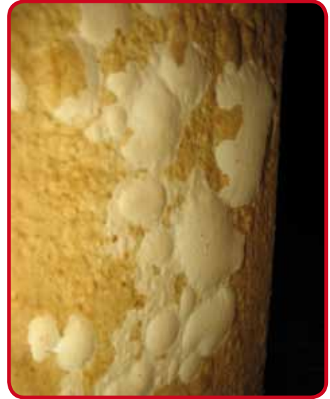
Cloques sur pilier, prêtes à s'ouvrir
