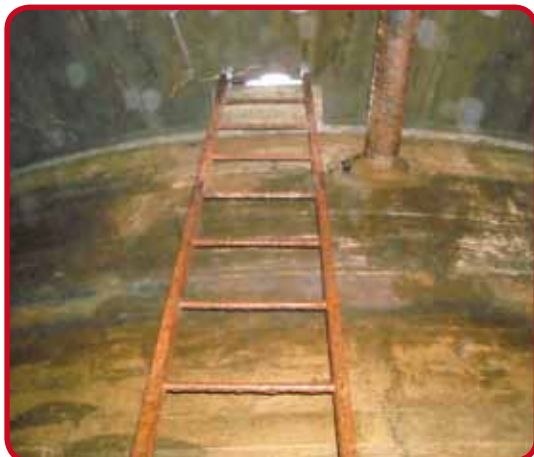
Échelle vétuste, aucune protection
