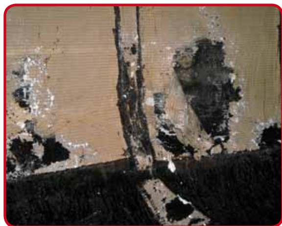
Feuille multicouche très dégradée
