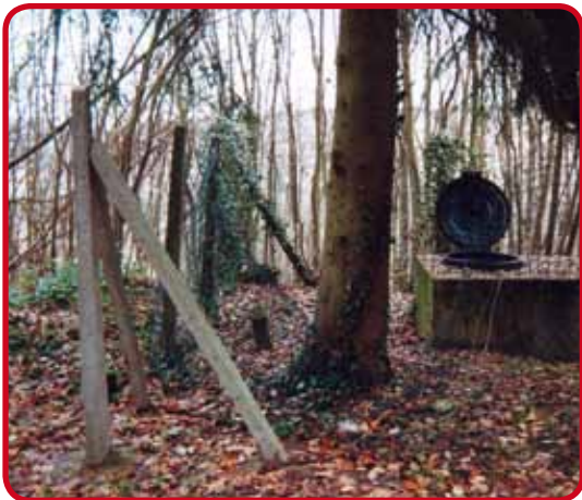
Grillage endommagé, végétation envahissante
