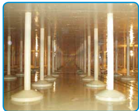
Réservoir entretenu, nettoyé et désinfecté régulièrement
