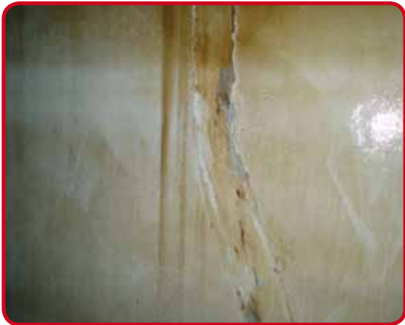
Fissure avec délamination du revêtement
