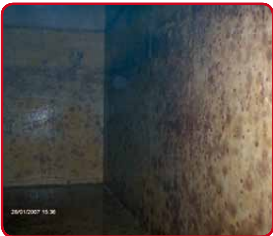
Développement de moisissures sous le revêtement
