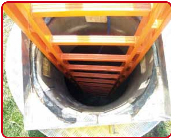
Trappe d'accès trop étroite, sans échelle fixe
