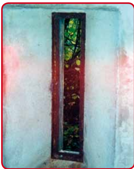
Aération non grillagée
