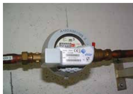
Compteur d'eau d'un abonné (source : OIEau)
