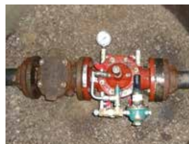
Vanne de régulation de pression (source : OIEau)
