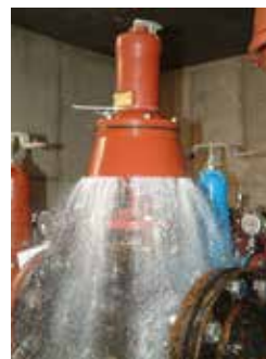
Soupape de décharge en fonctionnement (source : OIEau)
