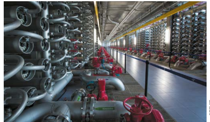
Traitement membranaire (nanofiltration) sur l'usine de production de Méry-sur-Oise
