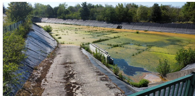
Figure 21 : Exemple de rampe facilitant l'accès motorisé au bassin de rétention. Source : Cherqui.
