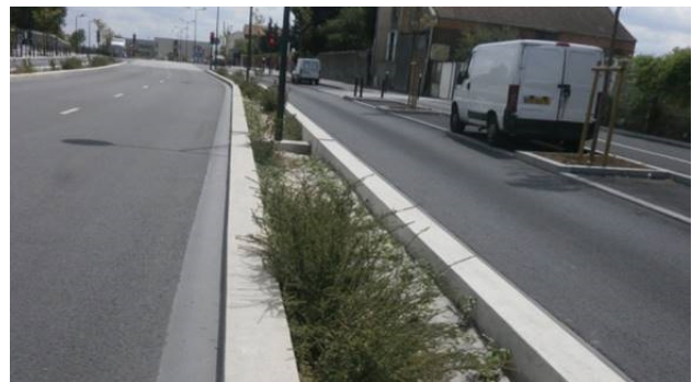
Figure 20 : Exemple d'ouvrage présentant un accès difficile, voire dangereux pour les agents, entre 2 voies de circulation. Plaine Commune. Source : Boudet.
