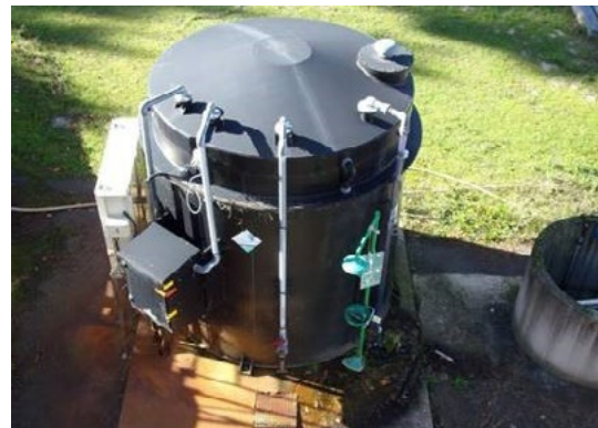
Unité de stockage et d'injection de chlorure ferrique (STEP SYDEC) Source : GEDEAU CONSEIL
