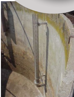
Vue générale drain inox Source : ASQEPTECE GROUP SAS
